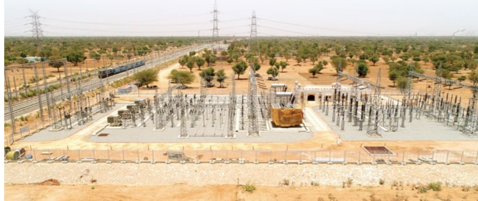
鉄道に沿って砂漠のなかに設置された変電所。1,500km内に等間隔に設置され、安定的に電力を供給する
