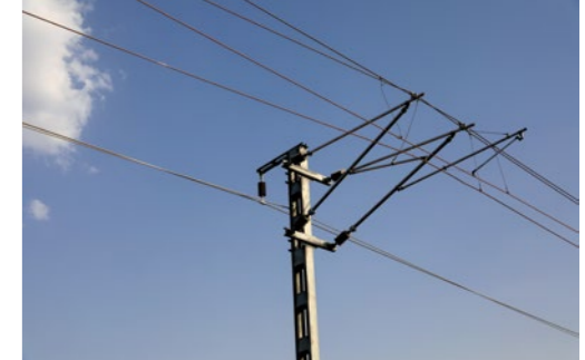
鉄道に電化の息吹を吹き込むトオリ線とそれを支える電柱
