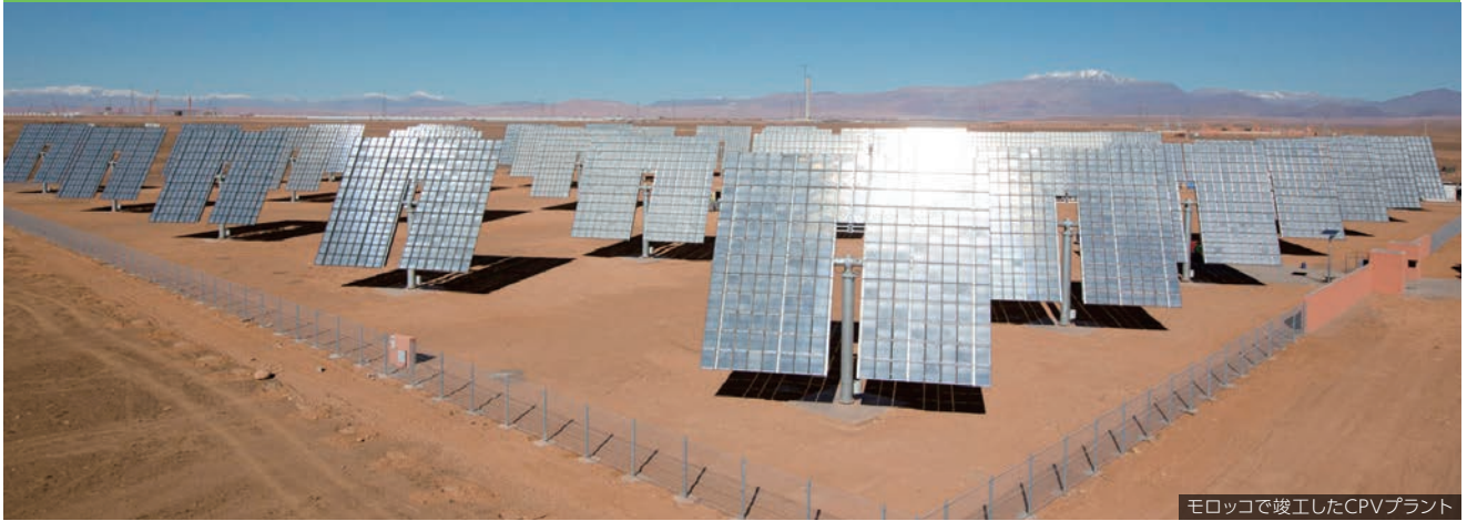
モロッコで竣工したCPVプラント
