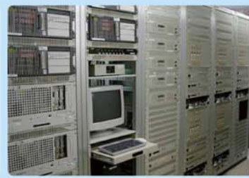
放送系センター設備
