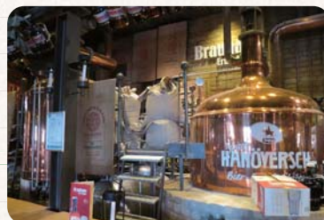
ビアホールの醸造設備
