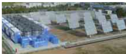
メガワット級大規模蓄電実証システム
